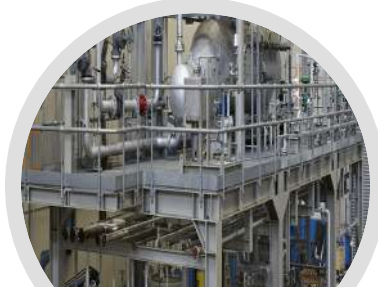
skid “MEG Regeneration” per PX Limited presso il sito Breagh Field – Teesside – UK
